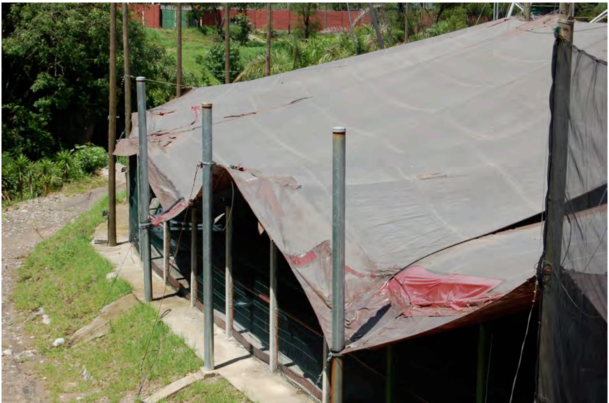
Fig. 2 Cubierta con deficiencias en la forma y ejecución
