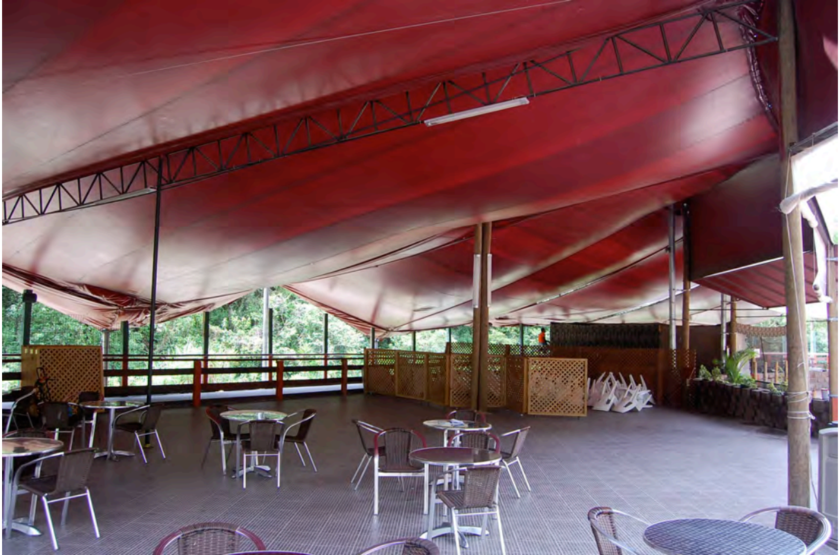
Fig. 3 Vista interior con áreas donde se acumula el agua
