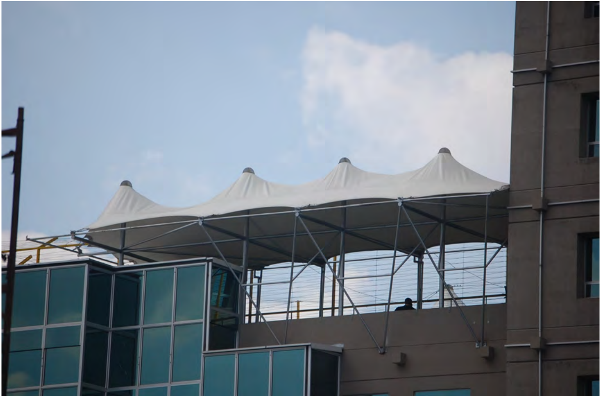
Fig. 1 Membrana de reciente instalación- nótese las arrugas y la estructura
