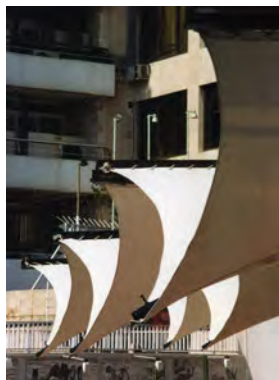
La membrana carece de refuerzo.
