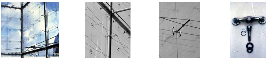
Figs. 7, 8, 9 e 10 – Estufas de La Villette, Paris: detalhe da fachada e do parafuso articulado com cabeça esférica
